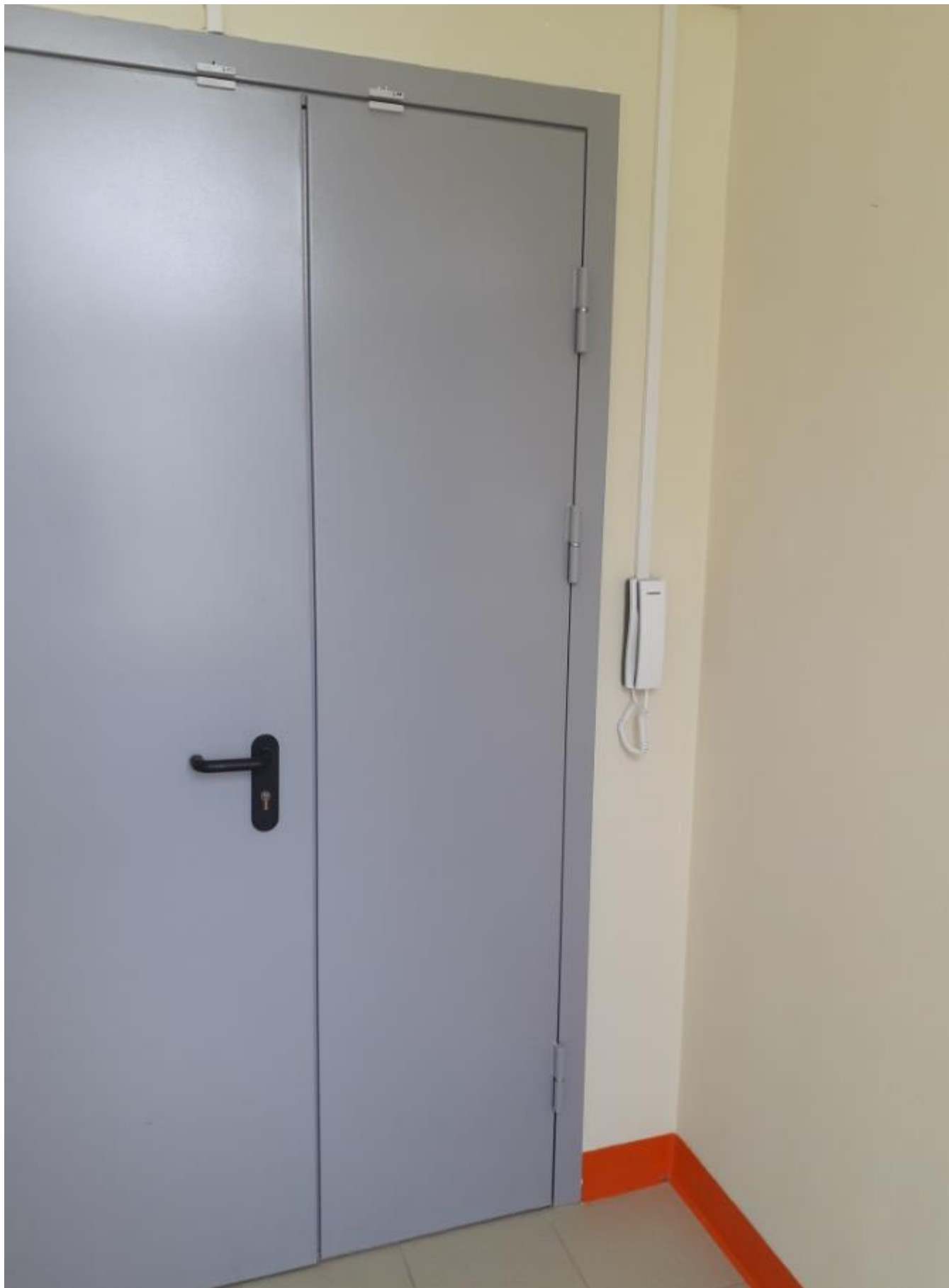
Переговорное устройство в лифтовом холле.
